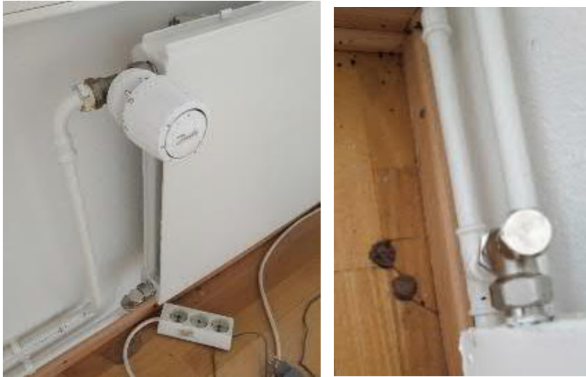
Kuva 7. Lämmityspatteri ja termostaattinen patteriventtiili. Oikealla näkyvissä vanhat ja tulpatut lämmityspattereiden kytkentäjohtojen läpivientipaikat lattiapinnassa.
