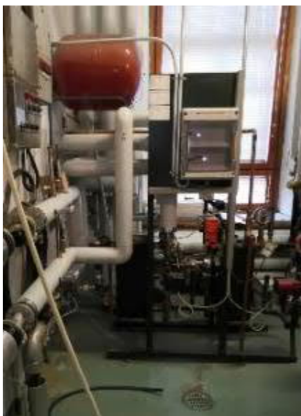
Kuva 6. Lämmönjakokeskus sijaitsee Aunela-rakennuksessa.
