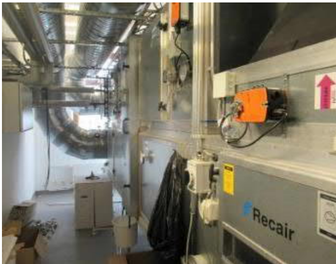
Kuva 8. Rakennuksen ilmanvaihtokonepaketti, valmistaja on Recair. Paketti on vuodelta 2013.
